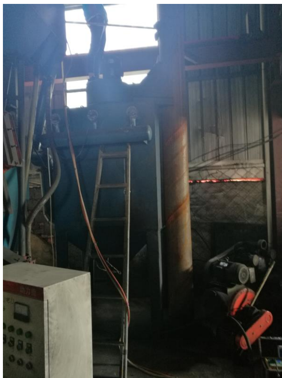
有组织废气现场采样
