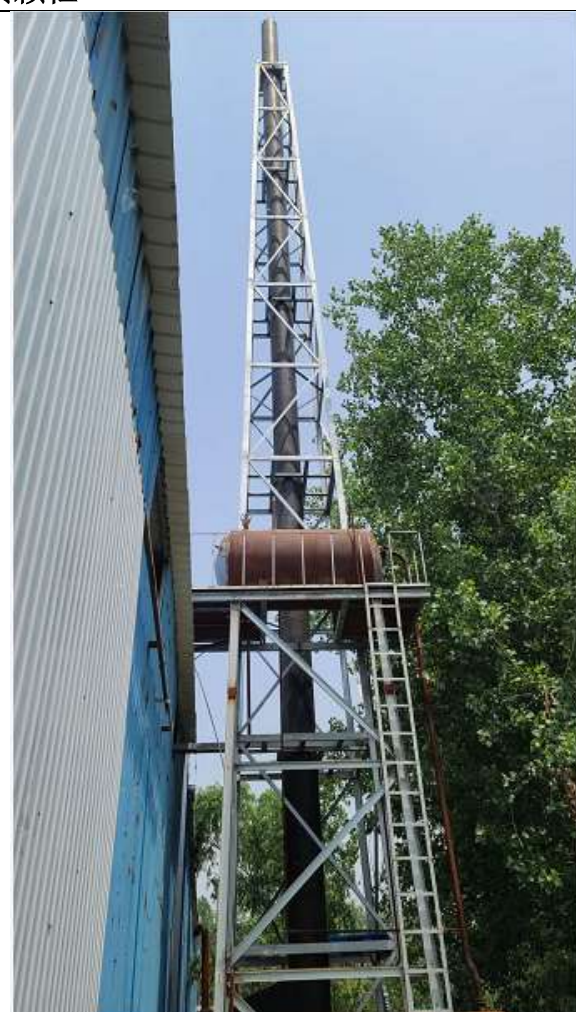
生物质锅炉废气排气筒 (H1)
