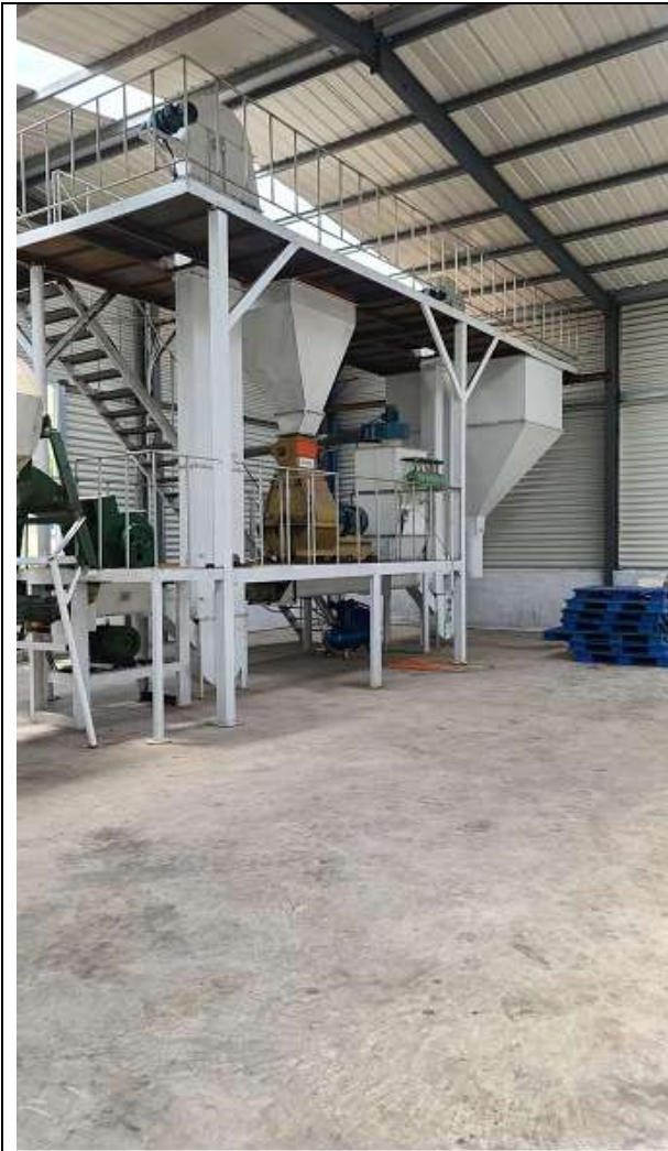
冷却下料、粉碎及包装工序布袋除尘器
