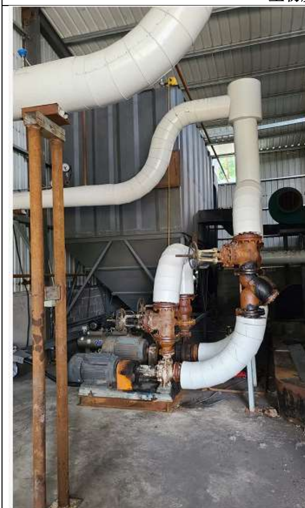
生物质锅炉废气布袋除尘器
