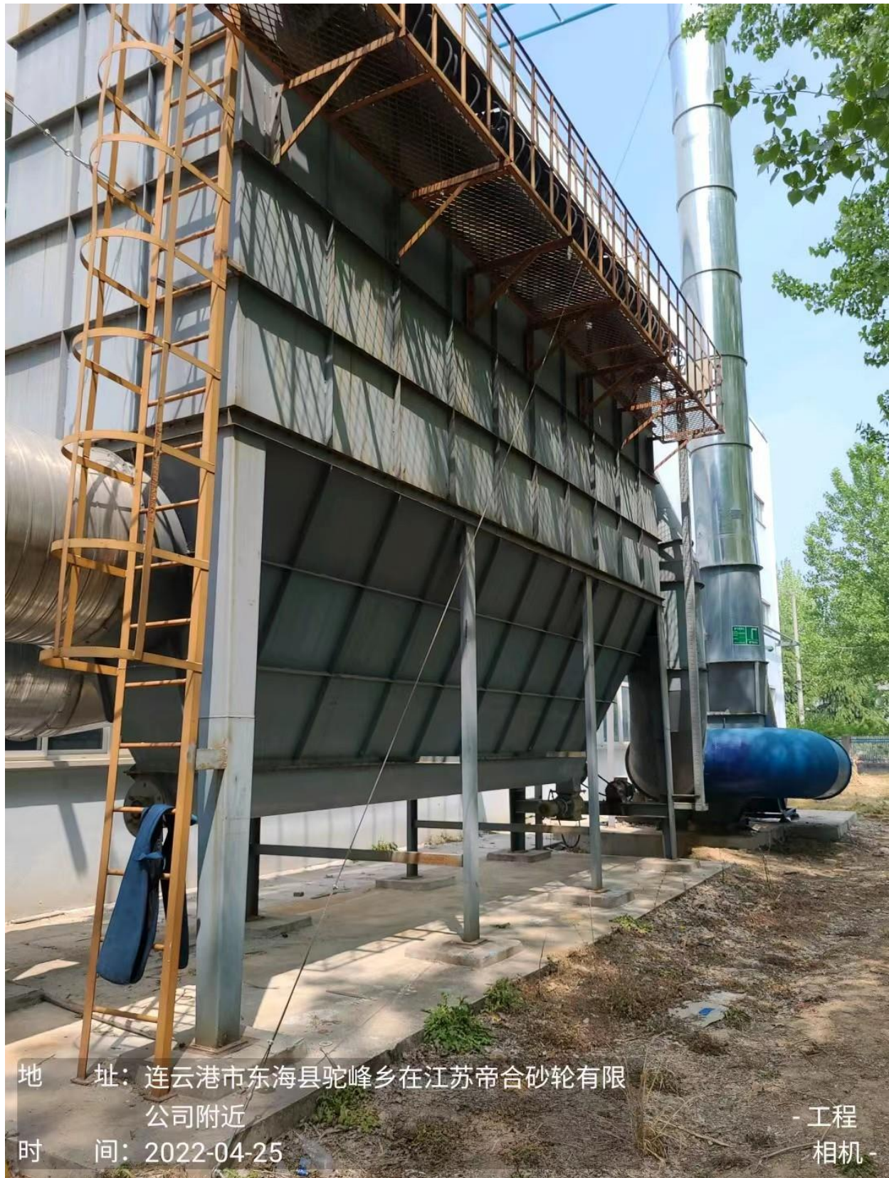
图 4-3 布袋除尘器废气装置
