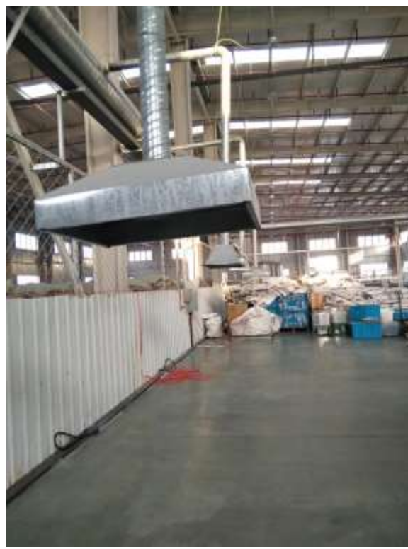
破碎机设施图片-2
