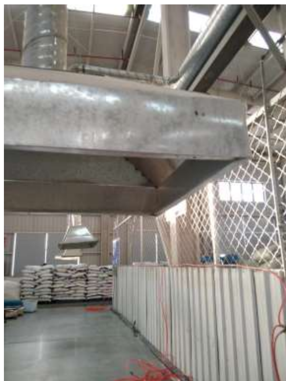
破碎机设施图片-1
