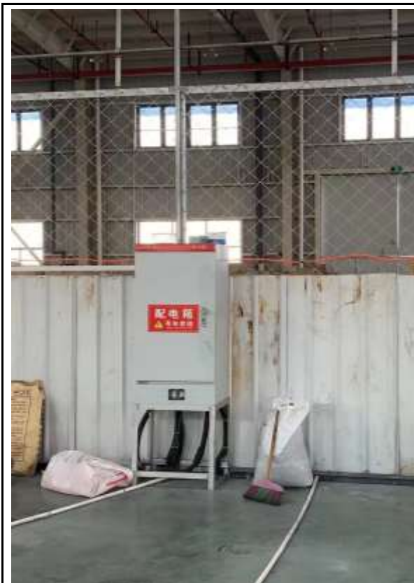
混料机设施图片-1
